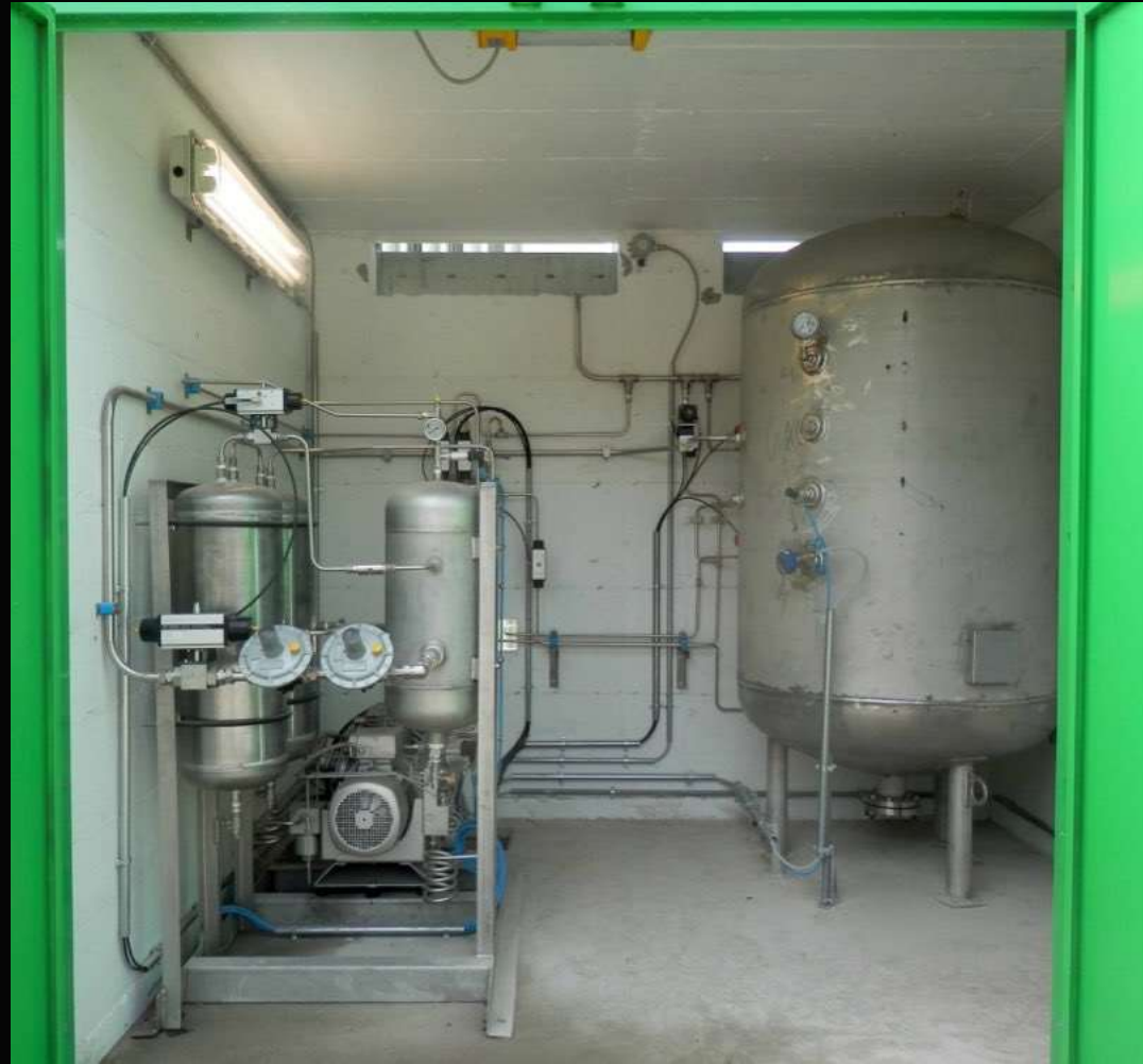
L'IMPIANTO DI RECUPERO DEL BOIL-OFF
