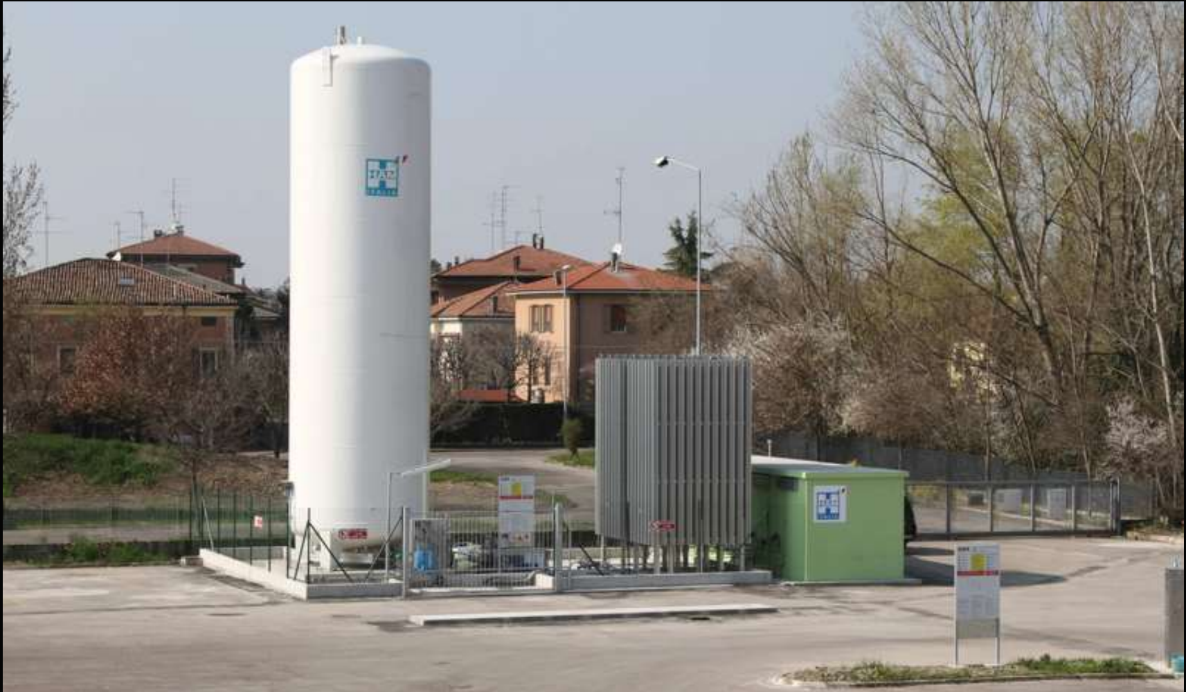
L'impianto GNL-C più grande e innovativo d'Europa, la Seta di Modena: 100 m3, 3 erogatori metano grande portata con impianto che rifornisce 130 Kg in meno di 5 minuti
